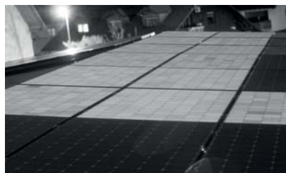
Elektrolumineszenzaufnahme zum Aufspüren eines Modulstranges
