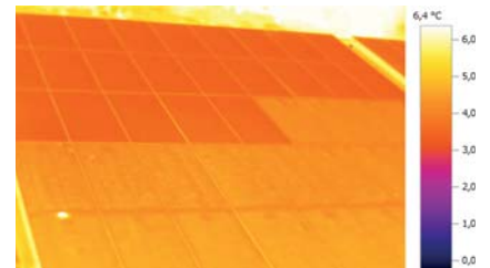
Solarmodul mit einem Hotspot an der Anschlussdose
