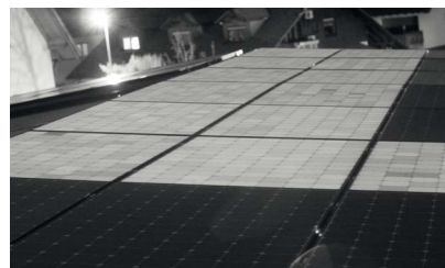
Elektrolumineszenzaufnahme zum Aufspüren eines Modulstranges
